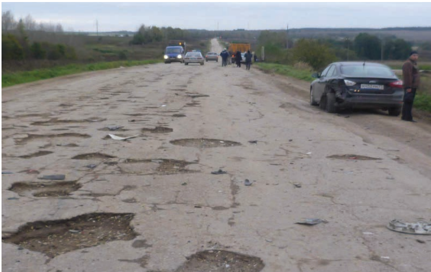
Рис. 9. Повреждения покрытия проезжей части (выбоины, просадки, проломы), затрудняющие движение транспортных средств, превышающие предельно допустимые размеры по ГОСТ Р 50597-2017
