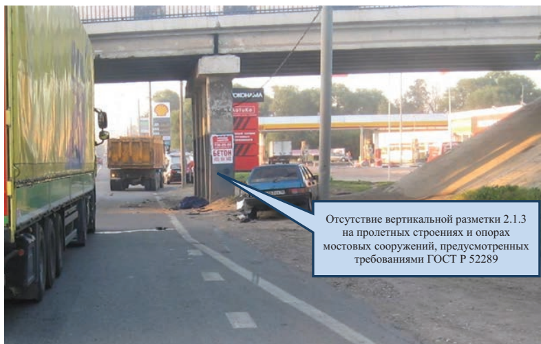
Рис. 22. Отсутствие, плохая различимость вертикальной разметки на пролетных строениях и опорах мостовых сооружений, торцевых поверхностях порталов тоннелей, ограждениях, парапетах, бордюрах и других элементах оборудования дорог в соответствии с требованиями ГОСТ Р 52289, коэффициент яркости и световозвращения менее значений по ГОСТ 32953
