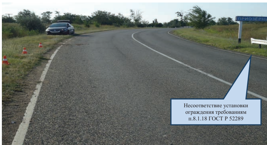
Рис. 26. Несоответствие установки ограждения, несоответствие высоты ограждения, несоответствие начального и конечного участков ограждения требованиям ГОСТ Р 52289
