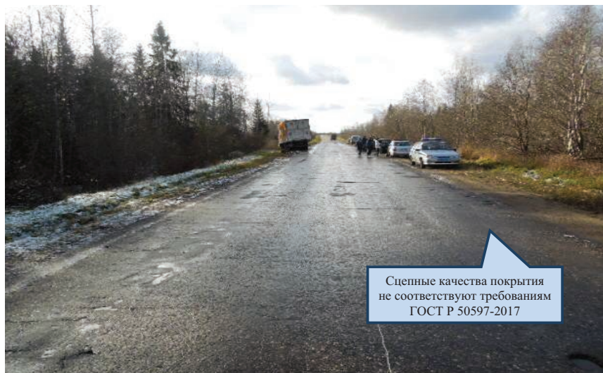
Рис. 15. Недостатки покрытия проезжей части (низкие сцепные качества покрытия), несоответствие требованиям ГОСТ Р 50597-2017
