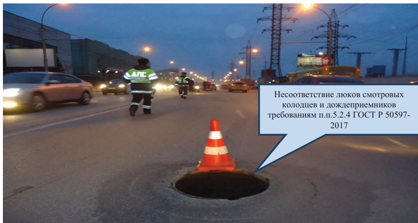
Рис. 32. Люки смотровых колодцев и дождеприемники ливневочных колодцев должны соответствовать требованиям ГОСТ 3634 (подпункт 5.2.6 ГОСТ Р 50597-2017)
