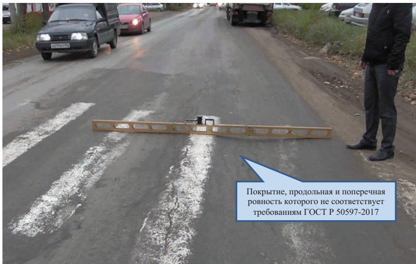
Рис. 20. Покрытие, продольная и поперечная ровность которого не соответствует требованиям ГОСТ Р 50597-2017
