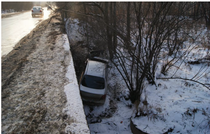
Рис. 19. Отсутствие дорожных ограждений в необходимых местах по ГОСТ Р 52289
