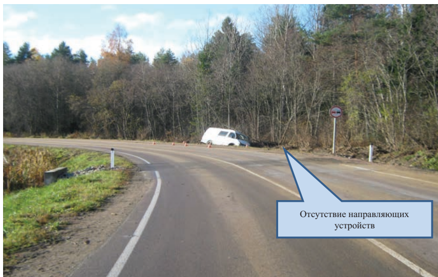
Рис. 31. Отсутствие и повреждение дорожных сигнальных столбиков на автомобильных дорогах
