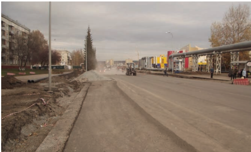
Рис. 28. Отсутствие временных технических средств организации движения в месте производства работ по капитальному ремонту дороги
