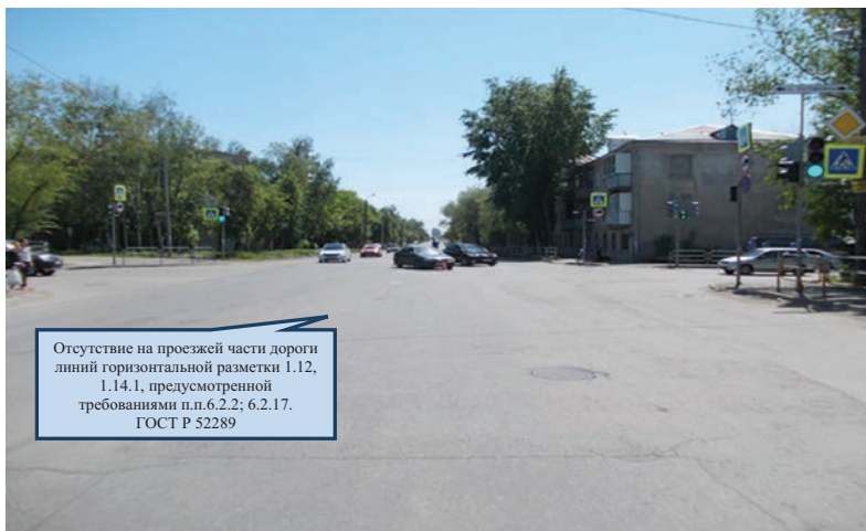
Рис. 5. Плохая различимость горизонтальной дорожной разметки – износ дорожной разметки по площади превышает значения, указанные в ГОСТ 32953, коэффициенты яркости и световозвращения – менее значений по ГОСТ 32953
