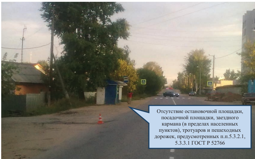
Рис. 30. Отсутствие элементов обустройства остановочных пунктов общественного пассажирского транспорта, несоответствие требованиям ГОСТ Р 50597-2017
